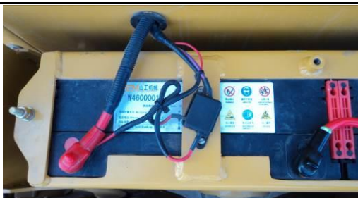
Подключение аккумуляторных батарей
